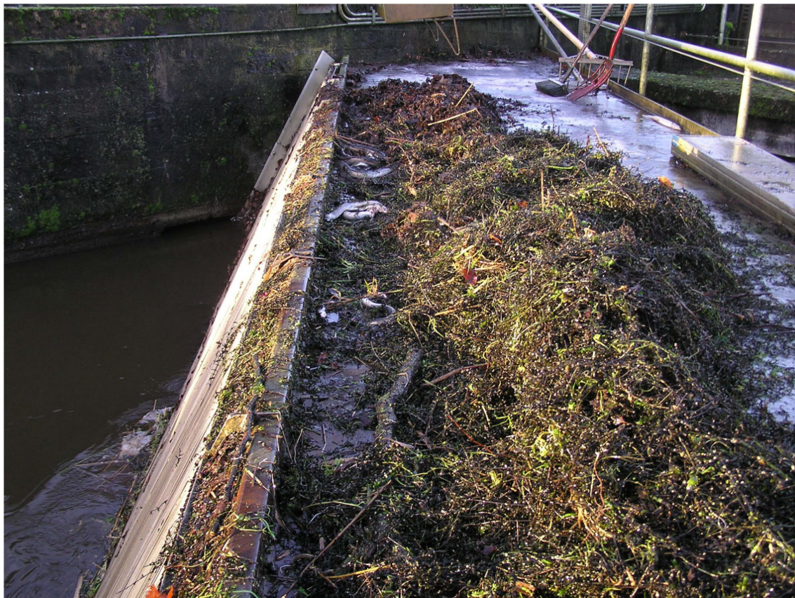
Figur 2. Vestbirk vandkraftanlæg. Ål fanget på gitteret og trukket op fra dette med den automatiske oprener 15. december 2006. Foto: Michael Ingemann Pedersen.
